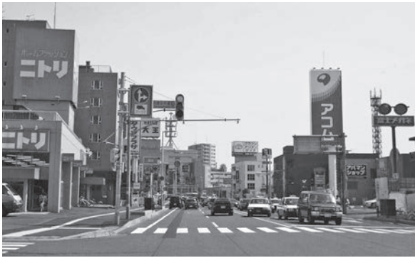
写真4 電線地中化工事の際に、街路樹をなくしてしまった国道36号月寒付近
